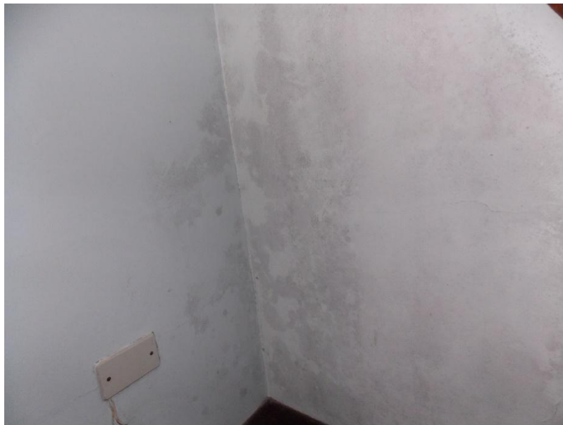
Figura 01 - Mofo e manchas provocados por insuficiência de ventilação
