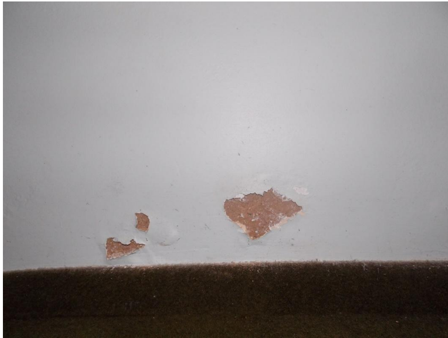
Figura 07 - Descascamento causado pela umidade no Domicílio
