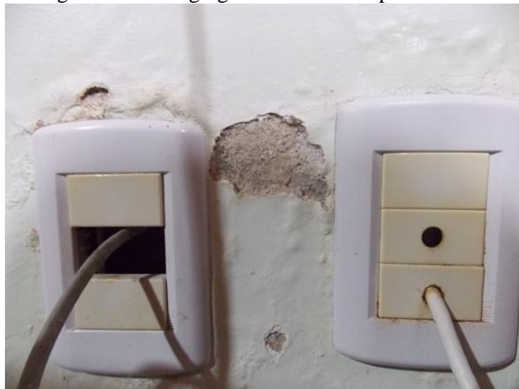
Figura 09 - Desagregamento causado pela umidade no Domicílio
