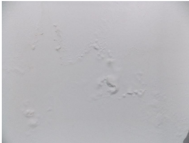
Figura 06 - Bolhas causadas pela umidade no Domicílio
