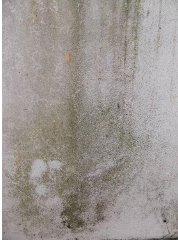
Figura 02 - Mofo provocado por excesso de umidade
