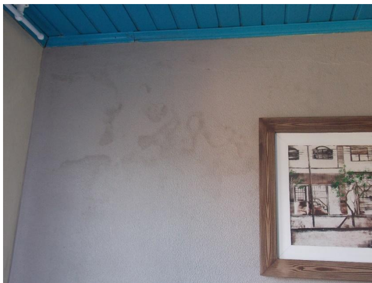
Figura 05 - Manchas causadas pela umidade no Domicílio
